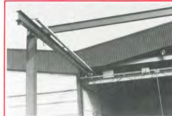
Abb. 1 Stromzuführung zu einer Kranbrücke. Die Kranbrücke fährt aus der Halle ins Freie.
